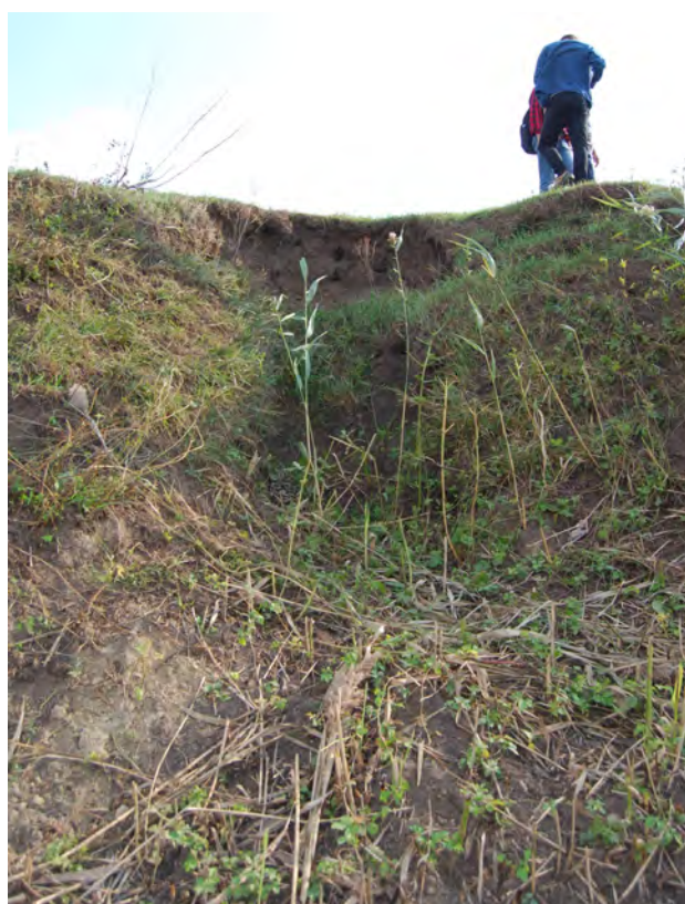
Figura 224. Arealul în care deversează apa găurile de piping din Figura 223.
