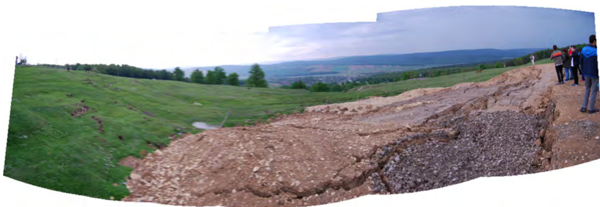
Figura 173. Alunecarea din primăvara 2017 a materialului utilizat la reconstrucția taluzului DC 49 după alunecarea din 2014.
