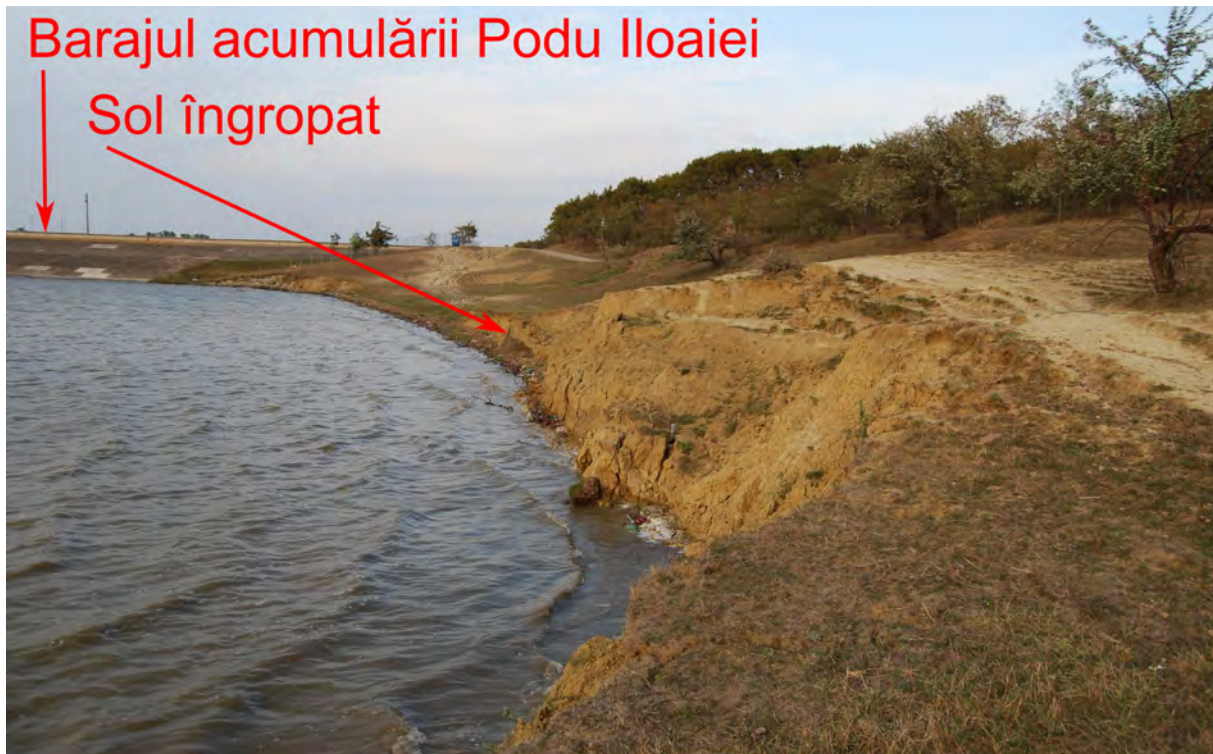
Figura 10. Alunecare rotațională (colaps) care afectează un deluviu de alunecare pe țărmul lacului Podu Iloaiei (jud. Iași).
